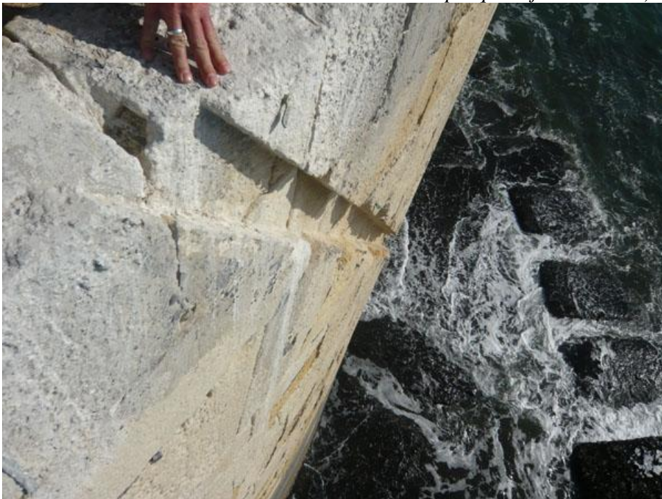
photo 9 : rainure reliant la fenêtre de la casemate du marégraphe à l'ancien quai Est du barachois
